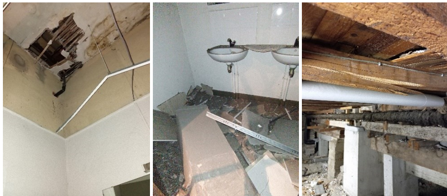
Sinistre dans les sanitaires de la Chapelle (Mai 2024)
